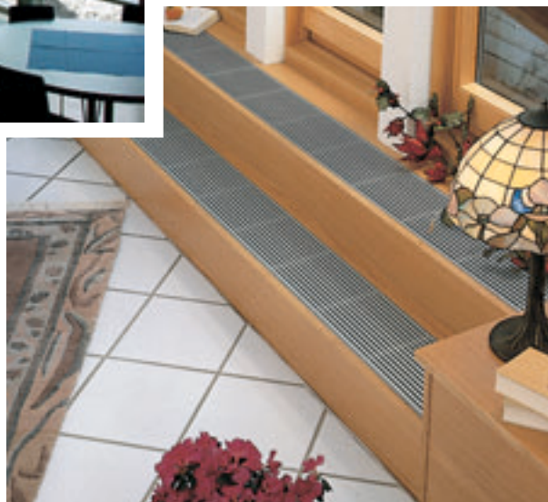
ill. 2.6: Un studio avec convecteurs de caniveau de GEA intégrés dans deux marches d'escalier. Cas de rénovation, c'est une bonne alternative architecturale.
