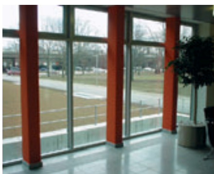
ill. 2.2: Convecteur de caniveau dans le hall d'entrée d'un bâtiment administratif. Une solution contre les parois froides.
